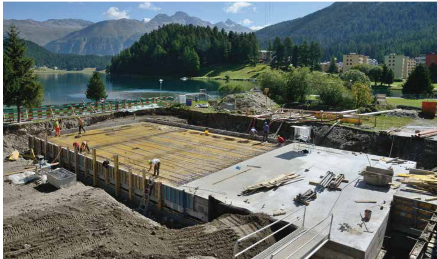
Als Gesamtenergieversorger realisiert St. Moritz Energie einen Energieverbund, um einen namhaften Teil von St. Moritz-Bad mit Wärme aus erneuerbaren Quellen zu versorgen und folglich den CO 2 -Ausstoss spürbar zu reduzieren.
