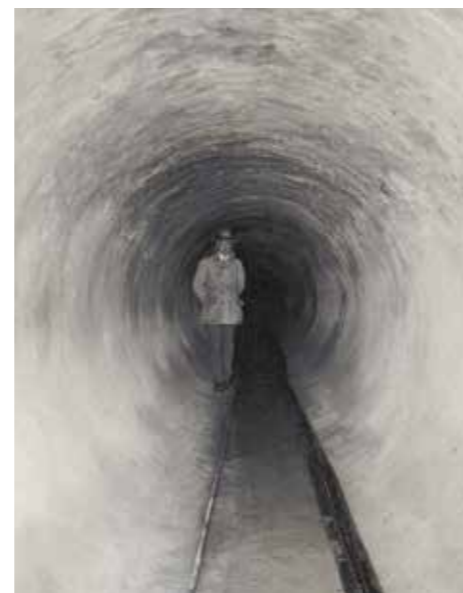
Badruttstollen mit 4300 Volt- und Telefonkabel
