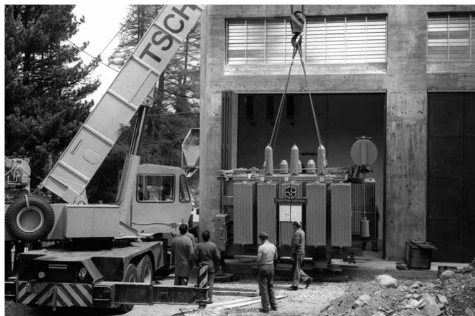
oben Transport des Transformators für das Unterwerk St. Moritz-Bad. Diese Anlage sowie das Unterwerk Islas werden über zwei unabhängige Leitungen von 60 kV Betriebsspannung gespeist. Von diesen Anlagen aus erfolgt über ein eng verbundenes Kabelnetz, das Mitte der Siebzigerjahre 42 Transformatorstationen bis hinauf in die Skigebiete von Corviglia und Marguns erstellt wurde, die Versorgung bis ins Val Saluver.
